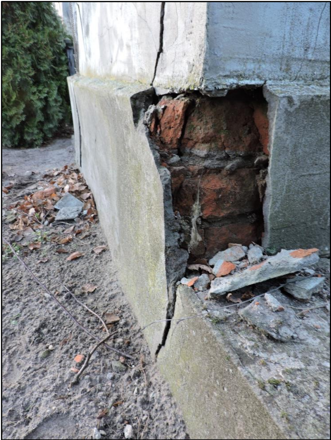
Fot. 9 Cokół pomnika, fragment, w polu widzenia spękania, ubytki tynku i zdestruowane cegły.
