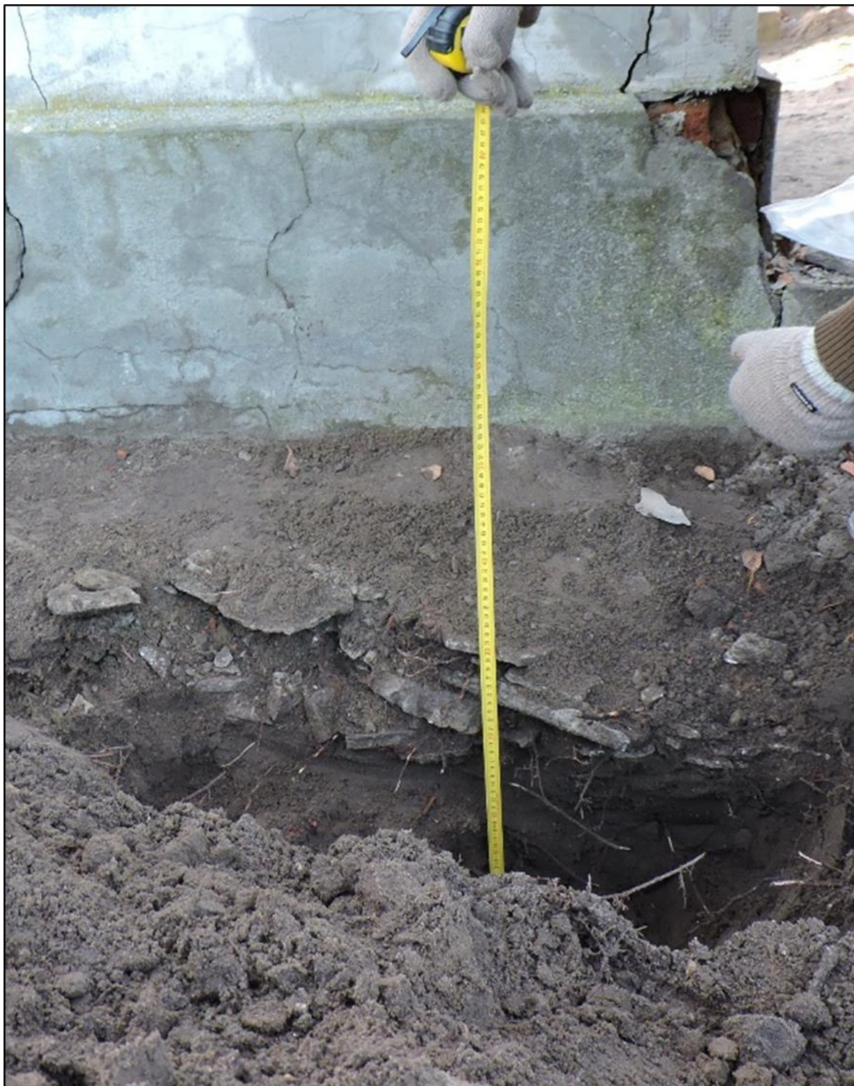
Fot. 10 Cokół pomnika, fragment, w polu widzenia sposób osadzenia płyt nagrobka na ubitym gruzie zalanym zaprawą.
