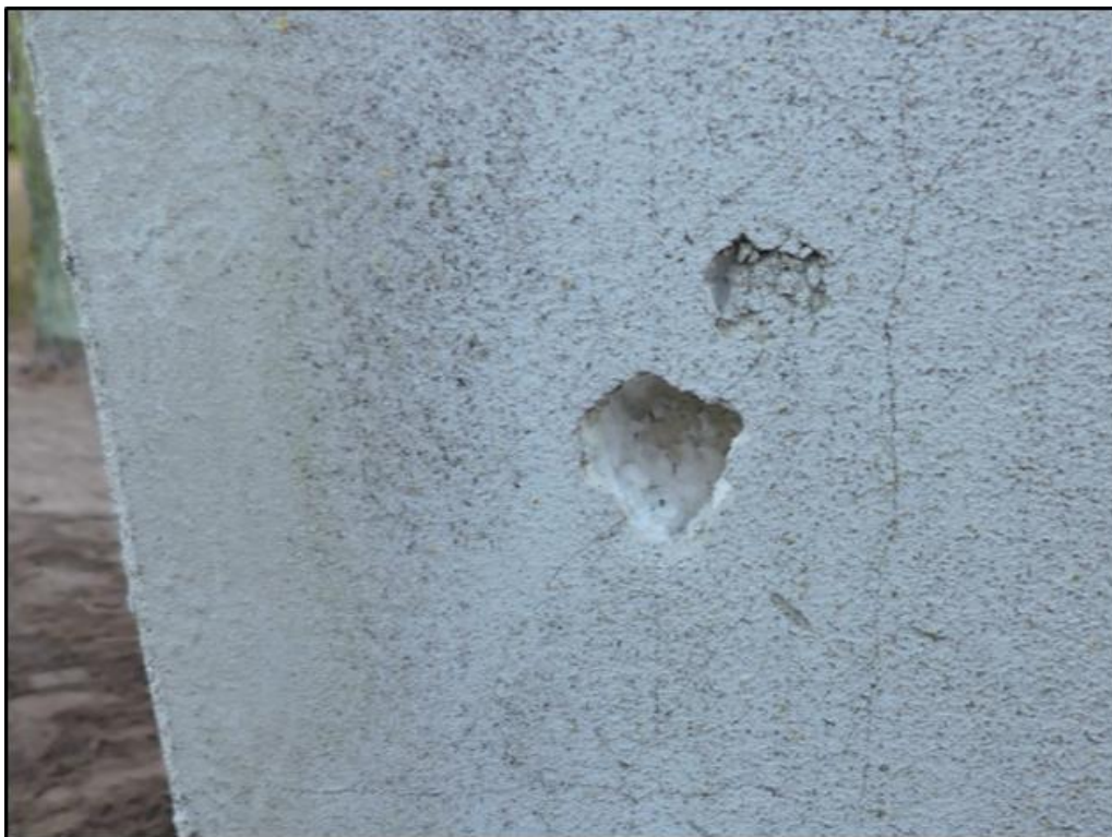
Fot. 6 Ściana boczna głowicy, fragment, w polu widzenia wtórne uzupełnienie ze styropianu widoczne pod tynkiem.
