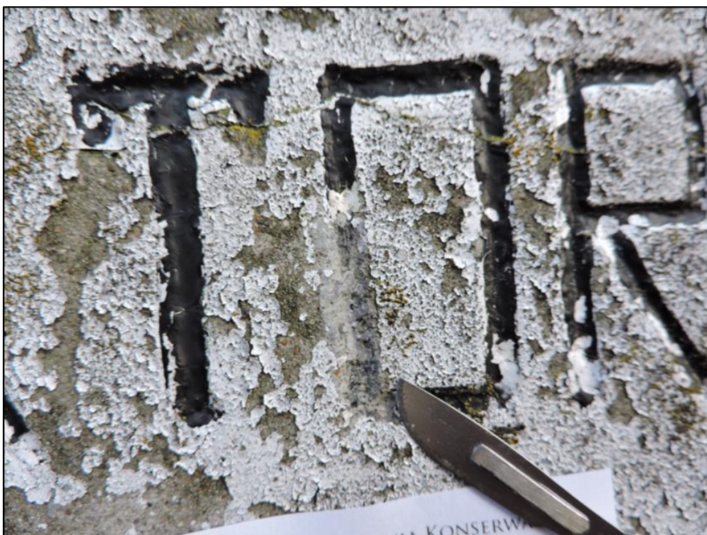
Fot. 4 Płyta inskrypcyjna, fragment, w polu widzenia silne łuszczenie wtórnej warstwy malarskiej.
