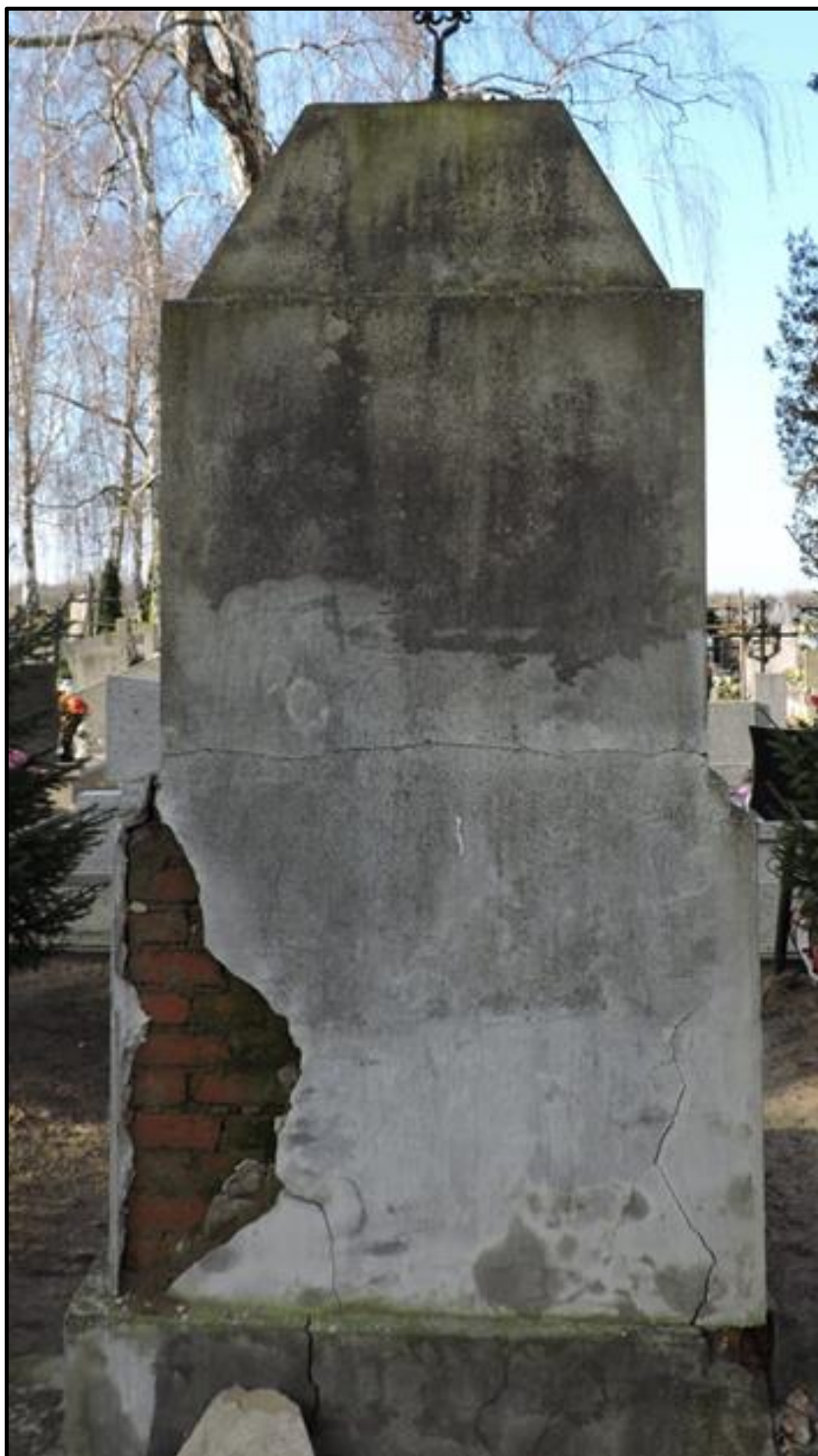
Fot. 5 Tylna płyta pomnika, w polu widzenia rozległy ubytek wtórnej wyprawy tynkarskiej. Powierzchnia silnie zabrudzona i pokryta mikroflorą.
